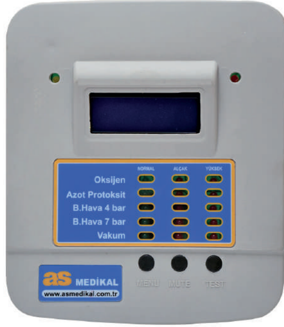
AS-GALx (Gaz Alarm Ünitesi)
